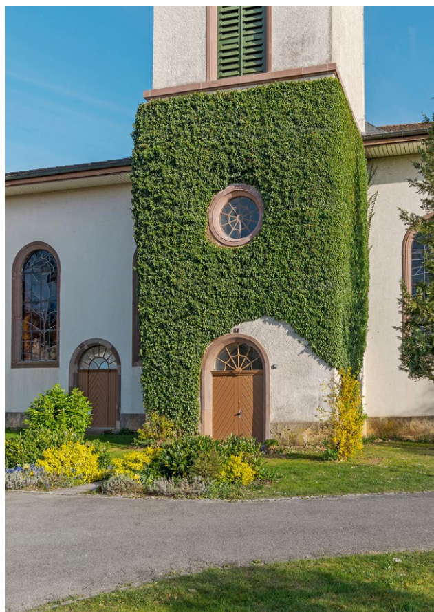
Das Eingangsportal der Kirche mit intensivem Grünbewuchs und profilierten Gewänden aus rotem Sandstein bei Türen und Fenstern.
